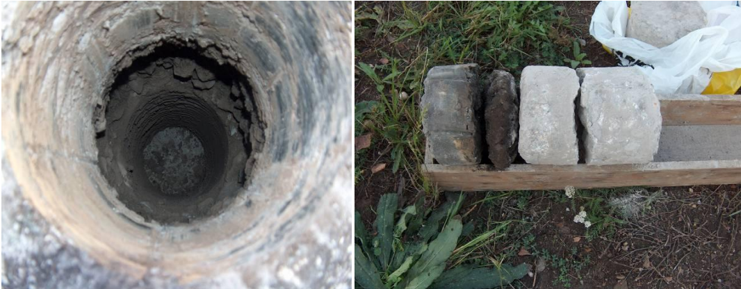
Obr. 2: Jádrový vývrt v povrchu vozovky na polygonu Most
