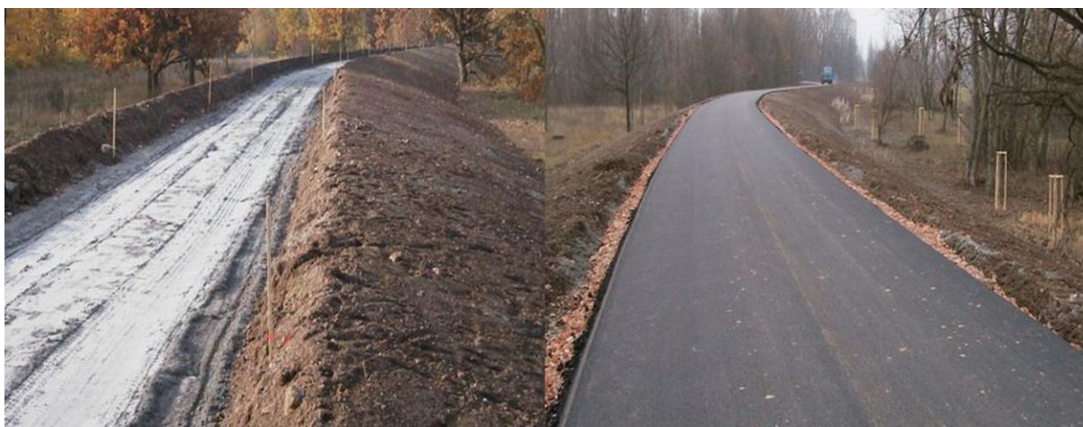
Obr. 4: Protipovodňová ochranná hráz s cyklostezkou s využitím VEP v Pardubicích v průběhu výstavby a po dokončení (foto Elektrárna Opatovice, 2014).
