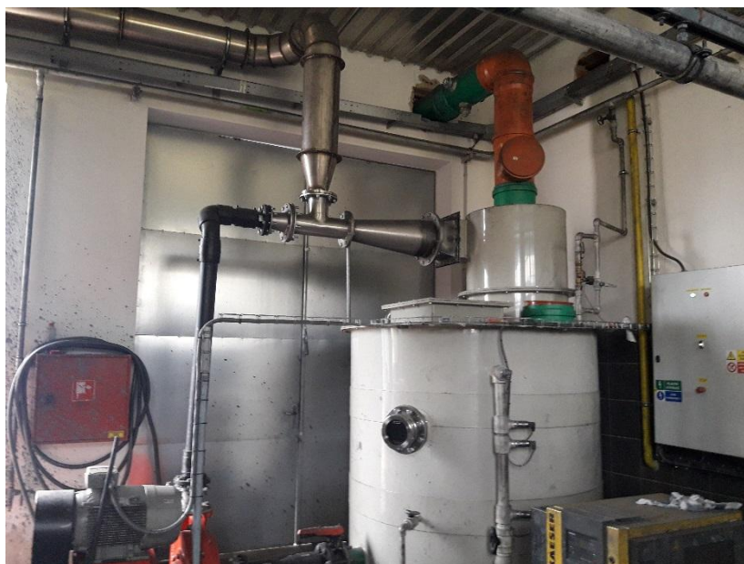
Obrázek 10: Konečná podoba ejektorové jednotky pro záchyt jemného dýmu právě uváděné do provozu.
