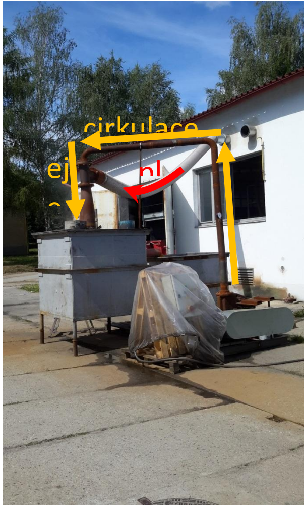
Obrázek 8: Provozní zařízení s ejektorem pro záchyt dýmu ve zkušebním provozu.
