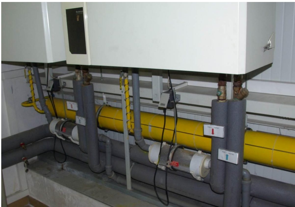
Obr. 11 Příklad instalace prototypu k ověření v reálných provozních podmínkách
