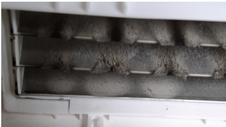
Obr. 4 Pohled na vnitřní lamelu cističky
