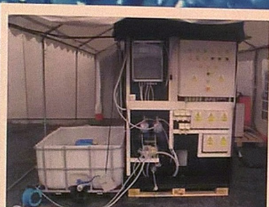
Obrázek 5: Oxidační zařízení ve skleněném provozu – pohled z druhé strany
