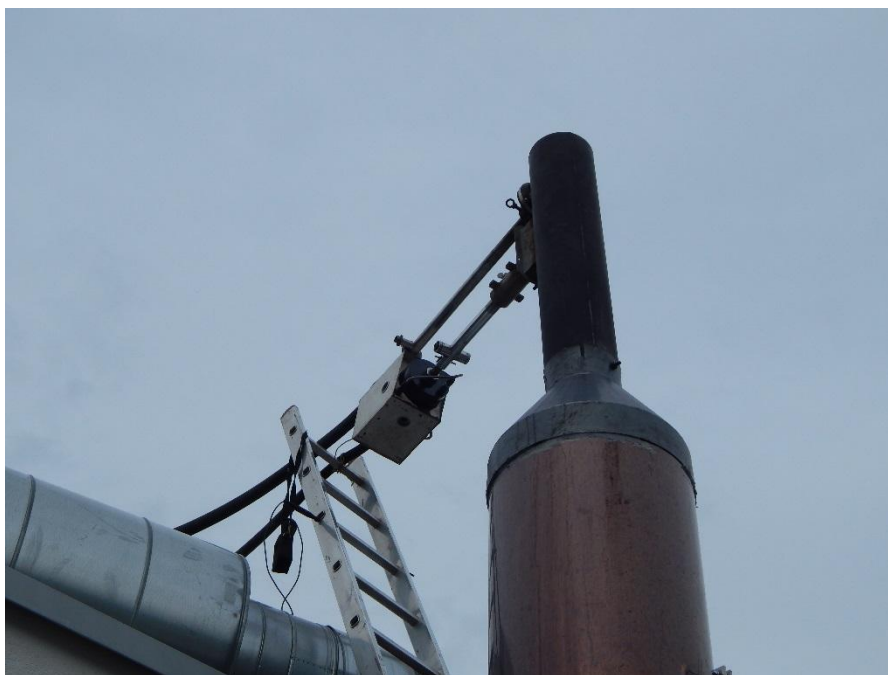
Obrázek 3-2 Instalace měřící aparatury
