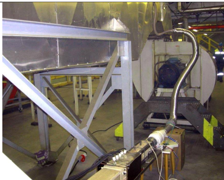
Ověření technologie HWC v praktickém provozu pomocí mobilní spalovací jednotky
