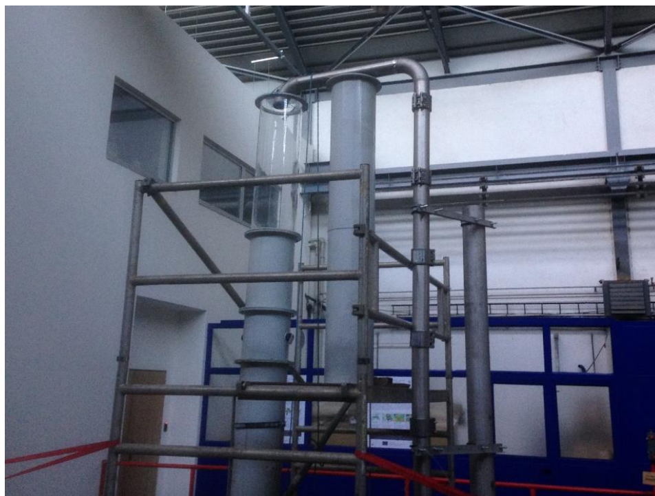
Obr. 9: Plastové potrubí při maximální výšce výtlaku.
