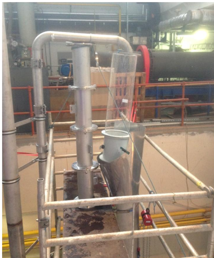
Obr. 8: Zavěšené plastové potrubí.
