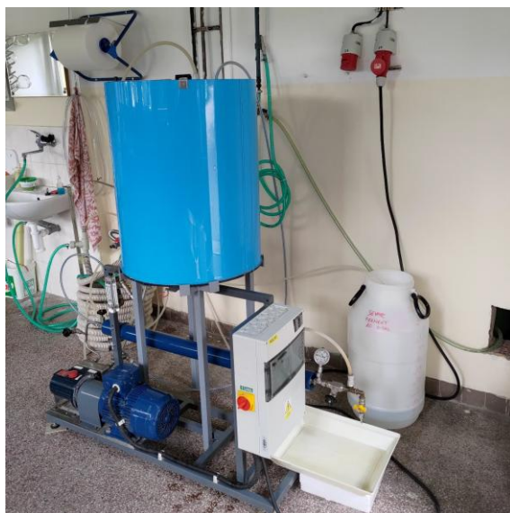
Obr. 6 Jednotka reverzní osmózy
