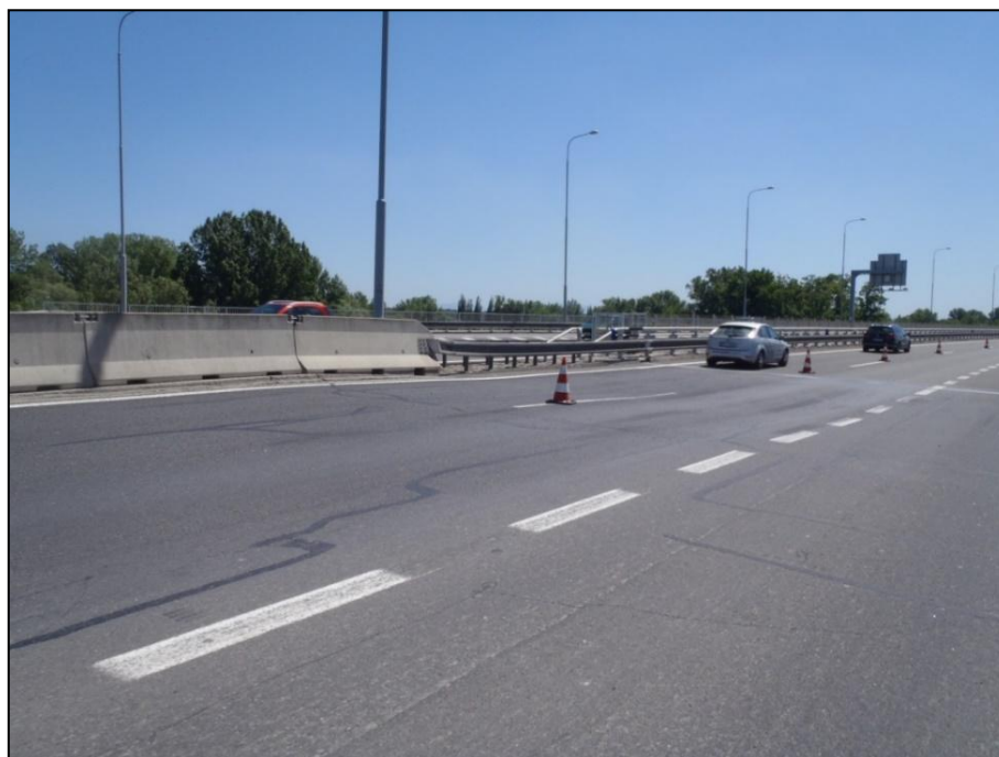
Obrázek 1 Deformace vozovky dálnice D47 v roce 2013 (po prvních opravách)
