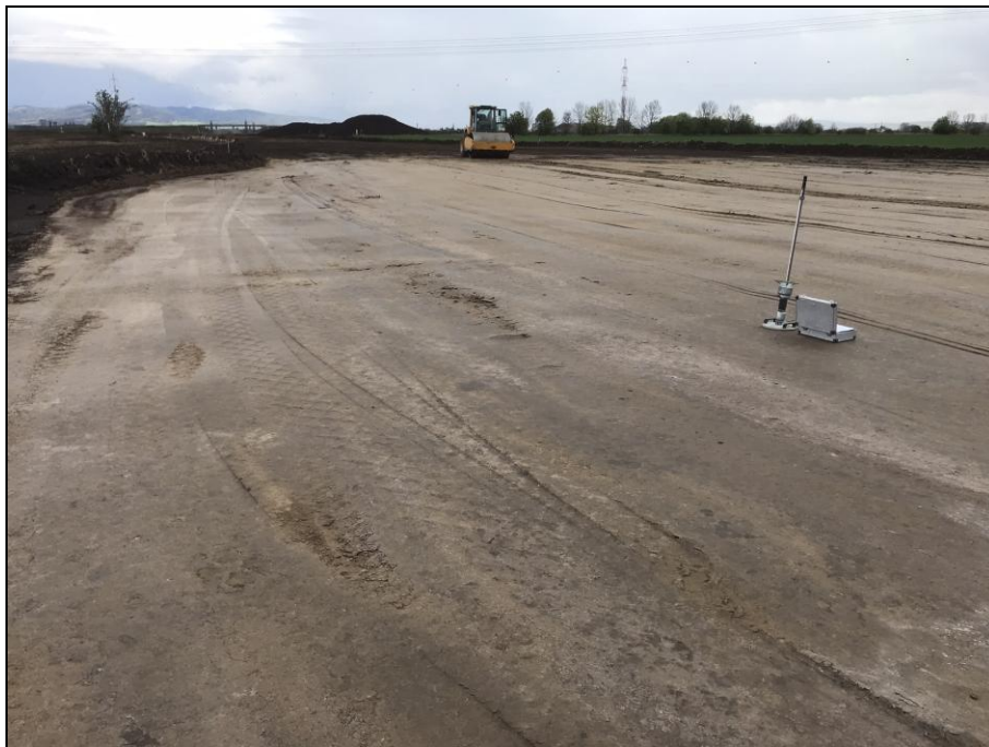
Obrázek 11 Zhutněná vrstva zemin upravených fluidními popílků z Teplárny Zlín v množství 2% při zhutňovací zkoušce na stavbě D49 Hulín – Fryšták dne 3.5.2022
